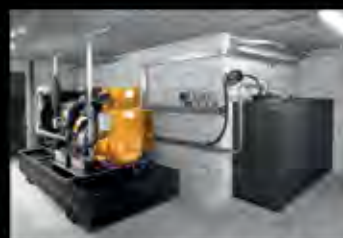
Noodstroomvoorziening hoofdzetel CEBEO Waregem
